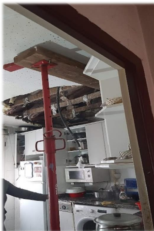
Ilustración 36: Una vecina de la calle La Estrella nos enseña su cocina con el techo derrumbado
