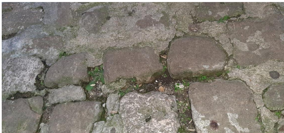
Ilustración 43: Zona escalonada y empedrada con muchos surcos y baches que requiere arreglos.
